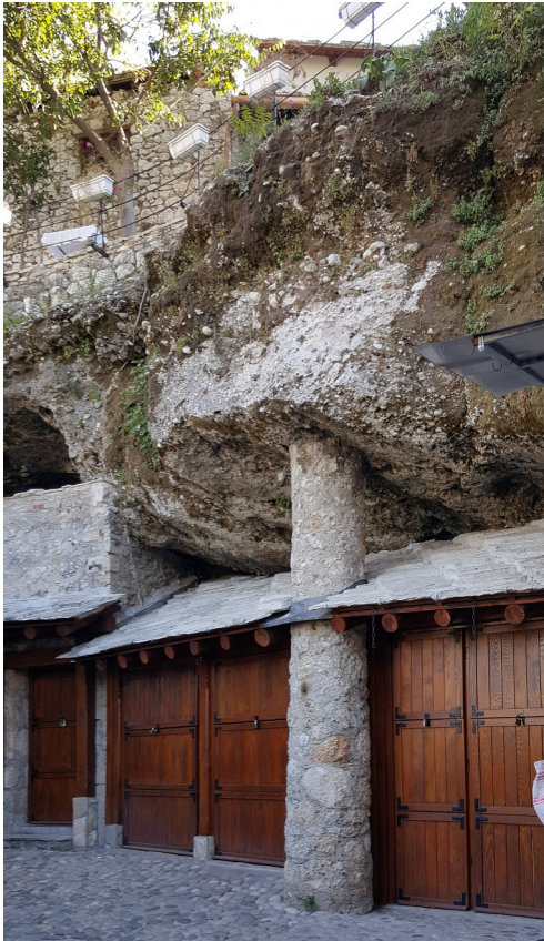
„Einfallsreiche“ Stabilisierung einer absturzgefährdeten Felsplatte aus Brekzie mittels eines gemauerten Pfeilers - in Mostar
